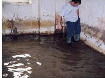
Nell'allagamento per tracimazione l'acqua è quasi sempre molto sporca, fangosa e contaminata da sostanze oleose (tipo gasolio che permane sulle pareti).
